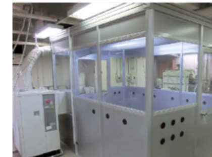
▲ダクトを室内に設置することで空気の流れを均一にできる
